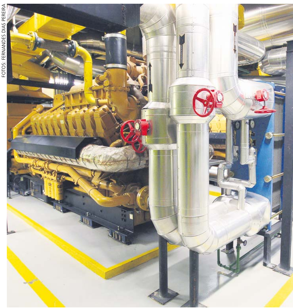
Central de cogeração: capacidade total instalada no Condomínio Rochaverá é de 11 megawatts
