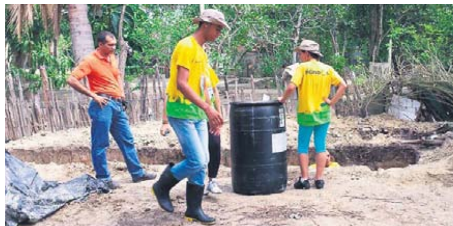
Universitários e professores do Projeto Rondon orientam a construção de fossa séptica
