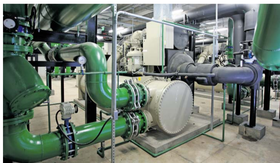
Poupar recursos – Sistemas e equipamentos sustentáveis, incluindo central de ar-condicionado
