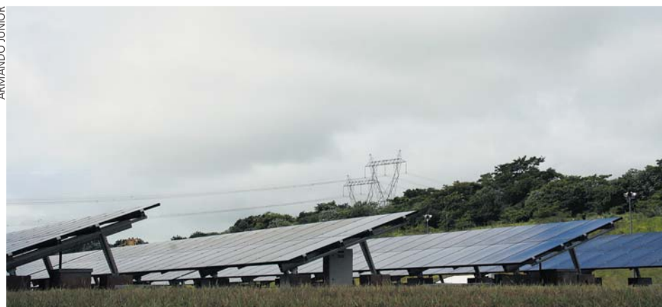
Usina solar flutuante da Cesp, em Rosana – Pode gerar 101,5 mil quilowatts
